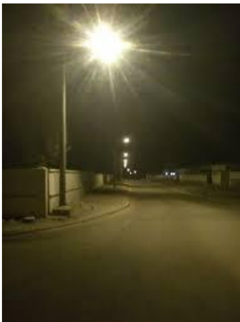
Photo 5 : photo d'un éclairage public
